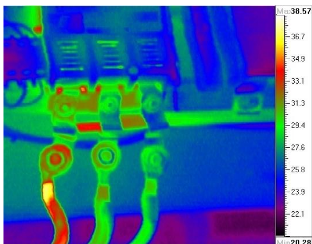
Рисунок 21. Пример термограммы контактных соединений с температурной шкалой
